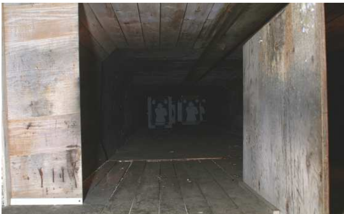
Fot. 28. KWP Poznań - OPP i OSP Poznań - strzelnica: jedna z 4 osi - stan w dniu 30.08.2005 r.
