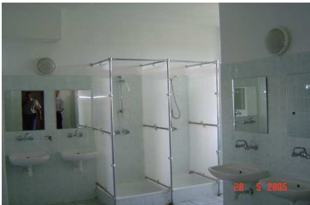
Fot. 9. KWP Łódź - OSP Sieradz - sanitariaty - stan w dniu 28.06.2005 r.
